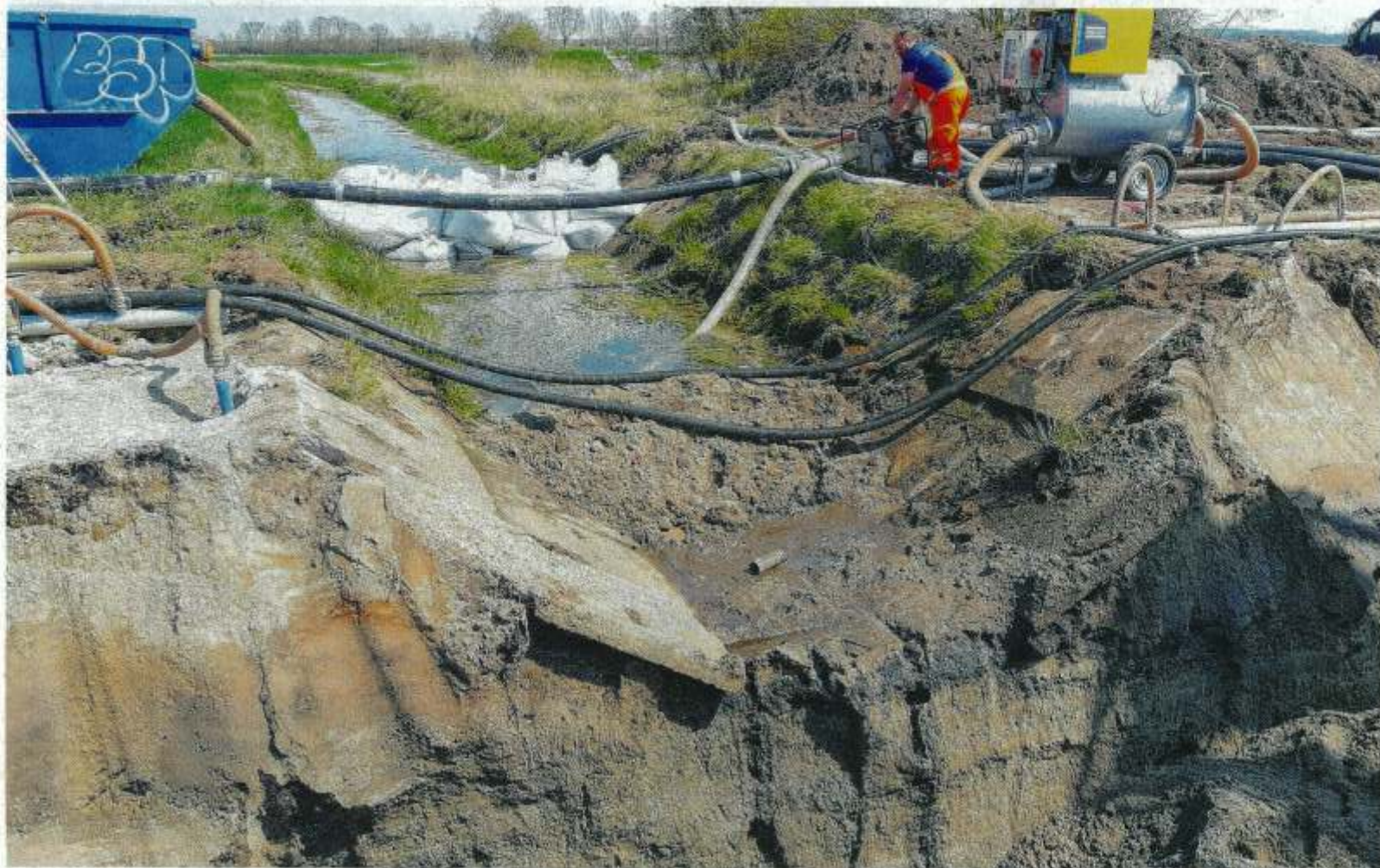
Die neue Trinkwassertransportleitung nach Elsterwerda musste zwischen Oschätzchen und Reichenhain den Teichgraben in offener Bauweise queren. Der betriebene Aufwand ist groß. Foto: WAV
