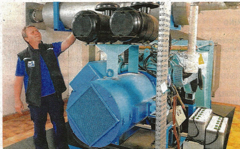
Heiko Pirschel, Meister Trinkwasserversorgung beim WAV Elsterwerda, an der Netzersatzanlage im Wasserwerk Oschätzchen.
