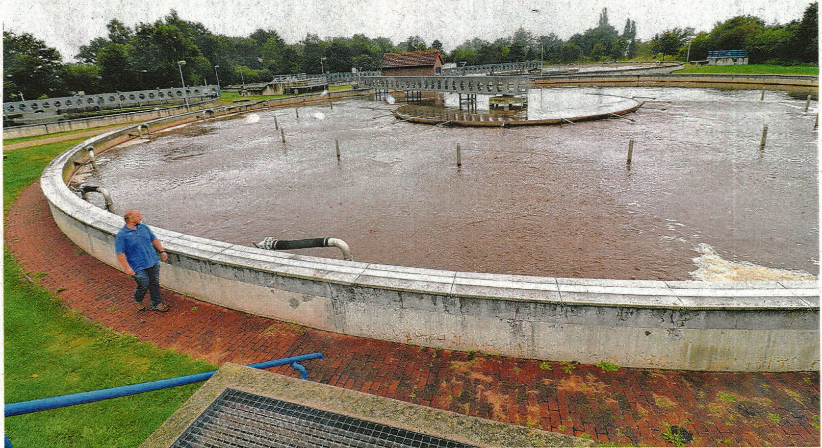
Sylvio Graf, Technischer Leiter beim WAV Elsterwerda, beim Kontrollgang am Belebungsbecken 2 der Kläranlage. Zu sehen ist, dass die Biologie in dem Becken belüftet wird, damit sie effektiv arbeitet. Ohne Strom sähe es dunkel aus. Foto: Manfred Feller
