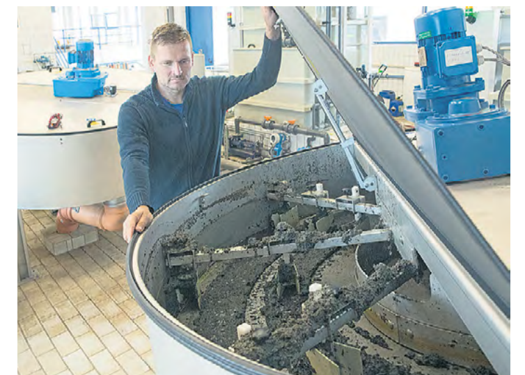
Abwassermeister Steffen Röthling beobachtet die Vorgänge im neuen Scheibeneindicker.
